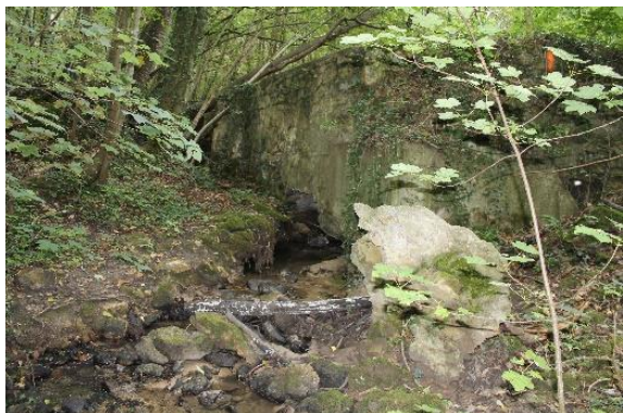
VUE DE L'AVAL DE LA BRECHE PRINCIPALE
