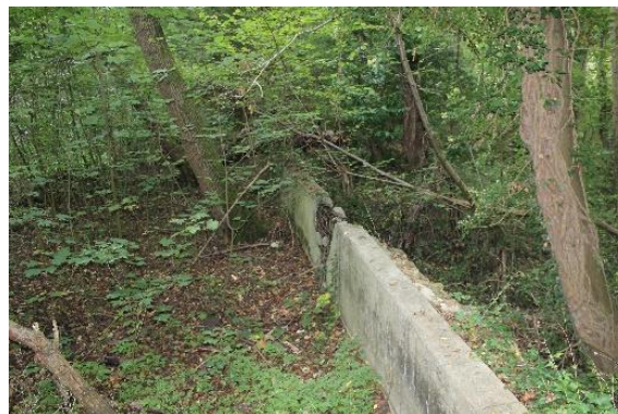
MUR A L'AVAL AVEC BRECHES
